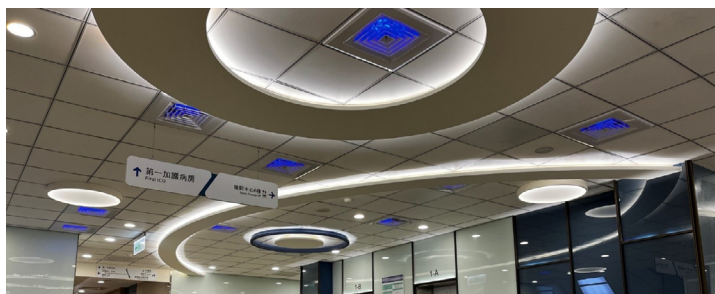
UVC 除菌器安裝於中央空調管路
