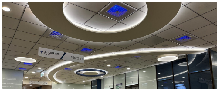
UVC 除菌器安裝於中央空調管路
