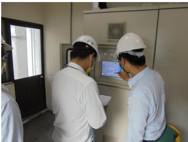
防制設備 RTO 現場查勘作業
