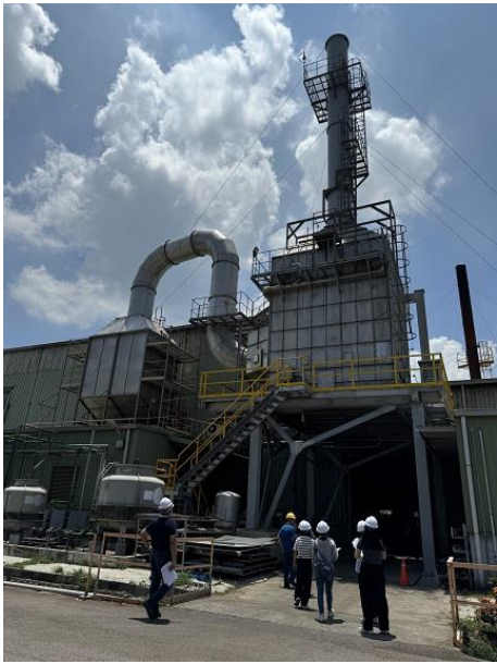
廠區空污防制設備查核
